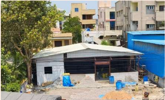
నోటీసులు ఇచ్చాక పనులు ఆగని రంగు వేసిన అక్రమ నిర్మాణం.
