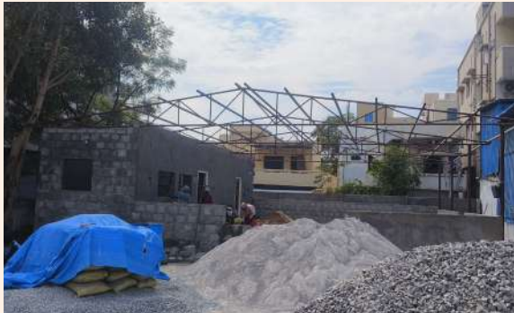
నోటీసులు ఇవ్వకముందు అక్రమ నిర్మాణం
